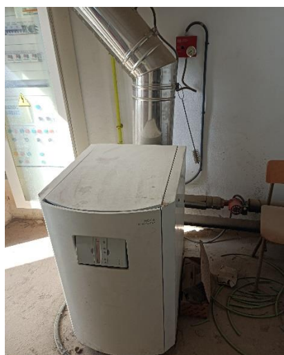
P.O. SECTOR 2 SALA DE CALDERAS
