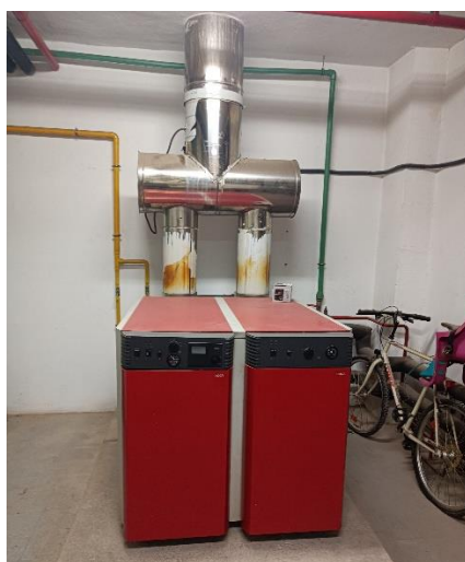
P.O. SECTOR 1 SALA DE CALDERAS
